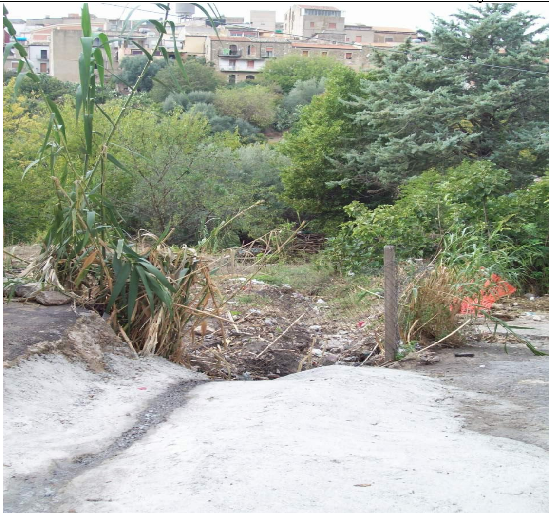
Riversamento su cabaletta in area privata ditta Maggio ed eredi Abate
